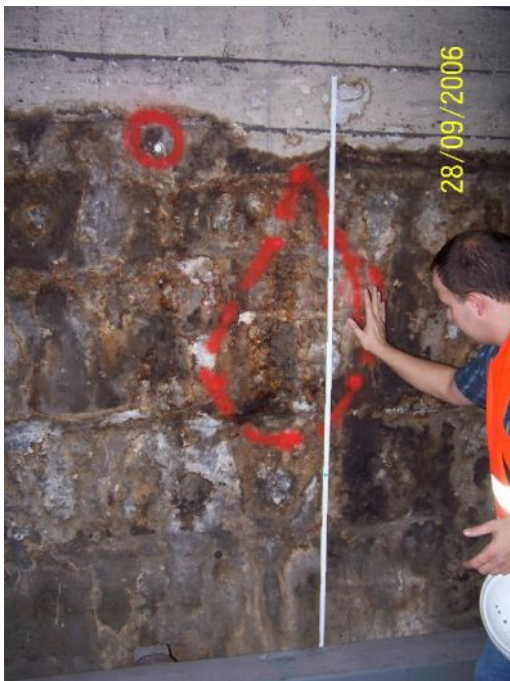
Bild 10 Teilbereich Schadstelle als Fotografie
