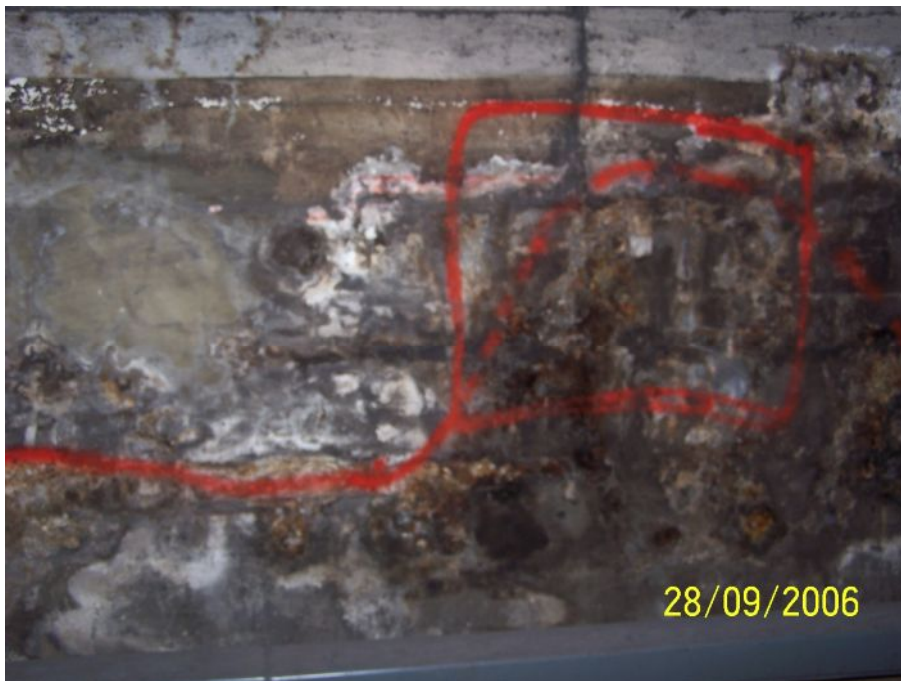
Bild 8 Teilbereich Schadstelle als Fotografie
