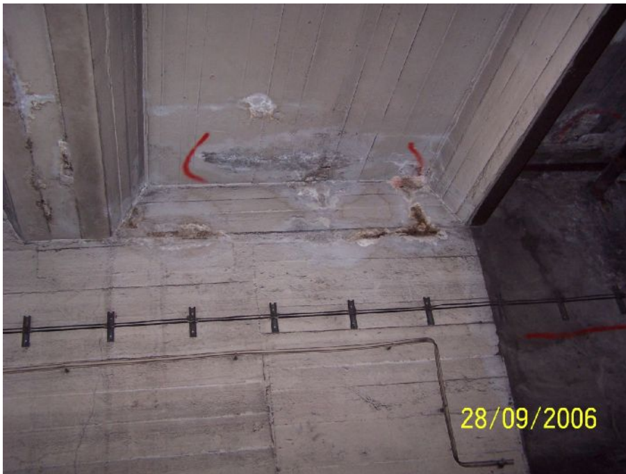
Bild 12 Teilbereich Schadstelle als Fotografie
