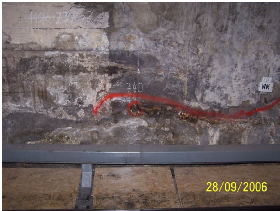
Bild 4 Teilbereich Schadstelle als Fotografie
