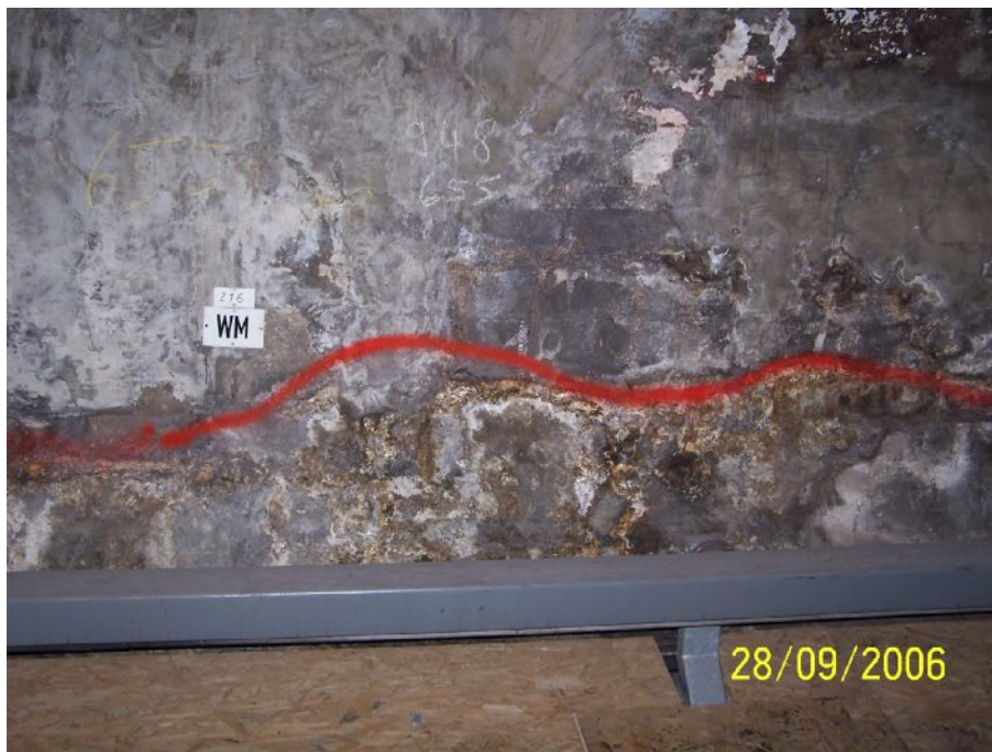
Bild 6 Teilbereich Schadstelle als Fotografie
