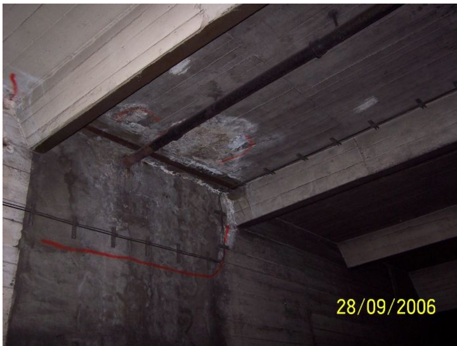
Bild 14 Teilbereich Schadstelle als Fotografie
