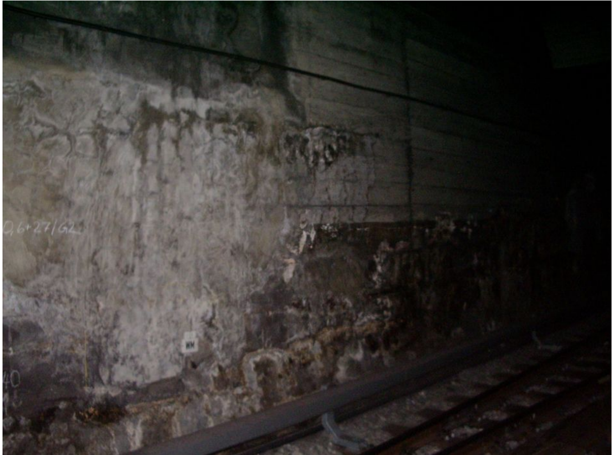
Bild 1 (Schadstelle bei km 110,6 +27 bis +50 (Einfahrt Hpu - Gleis 2) unbehandelt
